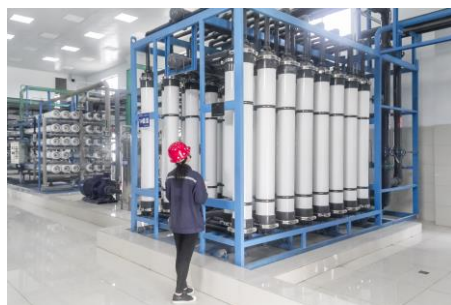
▲ 宜都园区膜处理装置
