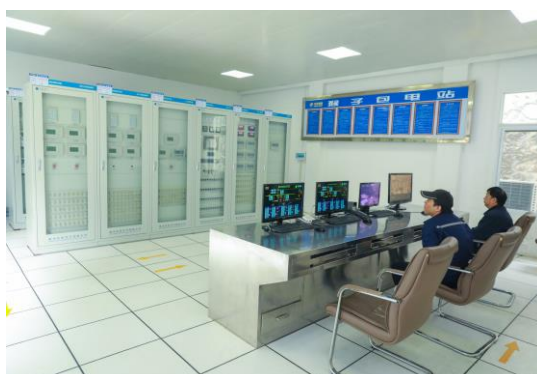
▲ 电站自动化监控
